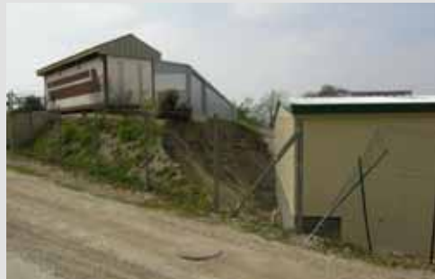
- talutage brutal dû à l'insertion d'une nouvelle construction de grande dimension sur un terrain accidenté - constructions provisoires en voie de pérennisation: exemple de la couverture récente du mobil'home
