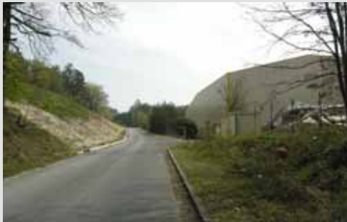
problèmes de ruissellement des eaux de pluies qui ravinent les talus sableux
